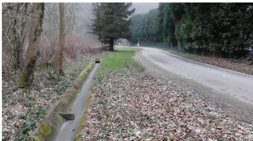
Photographie 3 : Aménagement de protection contre le ruissellement (RD279) (vue depuis l'amont)
