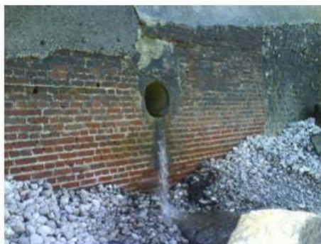
Figure 46 : Vue de la canalisation de surverse du rejet du système d'assainissement d'Yport
